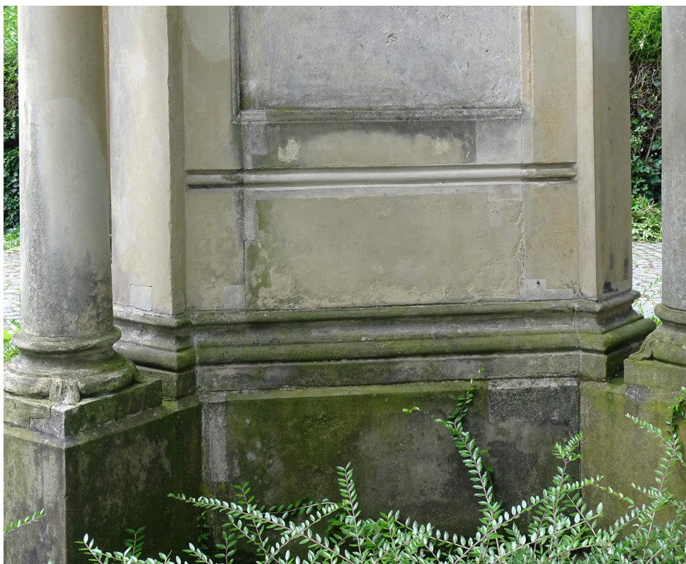
Bild 3: Zustand des Sockels; mit erkennbaren Rißbildungen.
