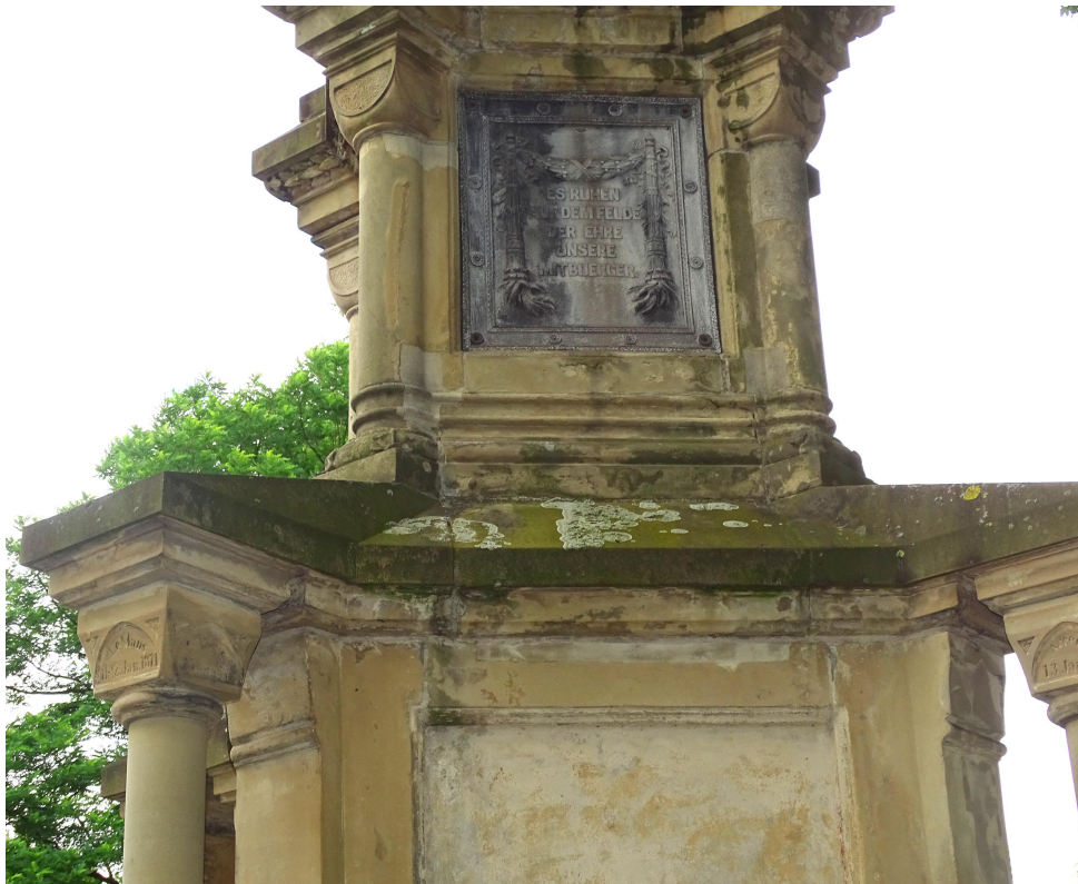
Bild 2: Detailansicht der u.a. witterungsbedingten Schäden.
