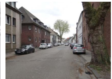
schadhafter Belag in der Straßburger Straße, Foto: LK Argus
