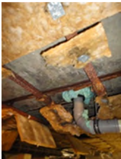
Foto Nr. 4 Unzureichende Dämmung der Fußbodenheizungsleitungen
