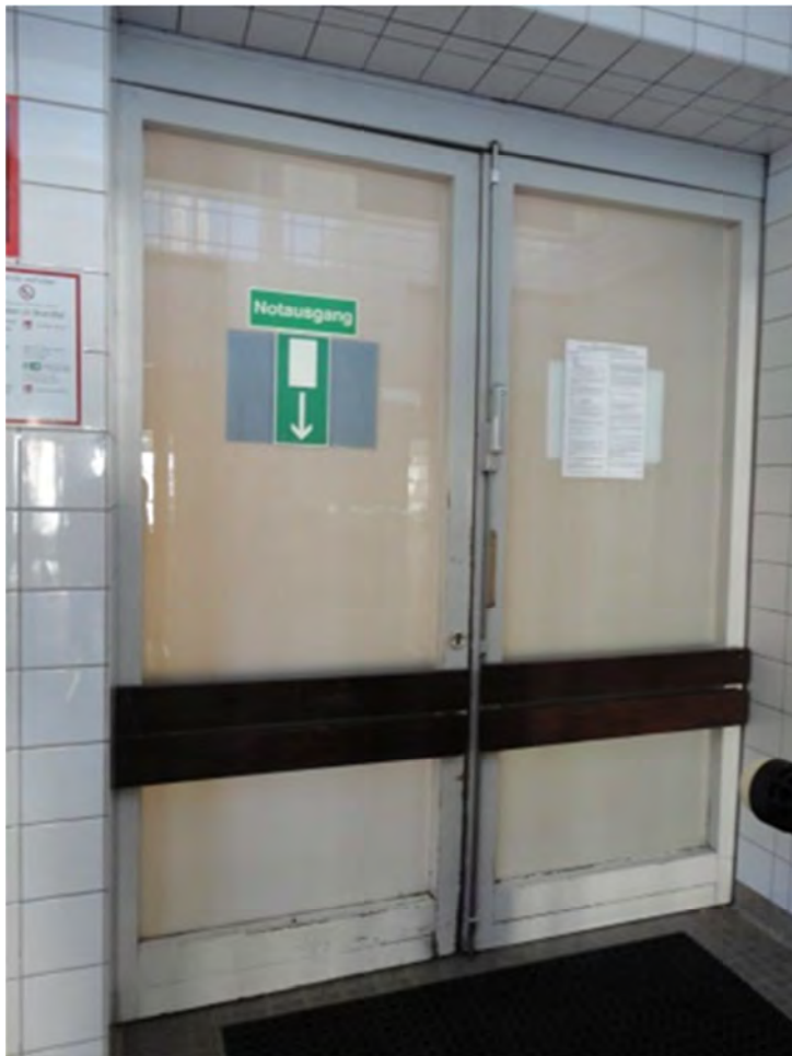
Foto Nr. 3 Einfachverglaste Außentür eines Lehrschwimmbads
