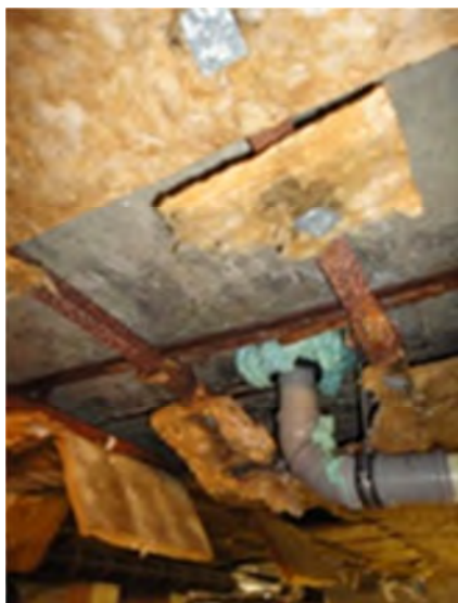
Foto Nr. 4 Unzureichende Dämmung der Fußbodenheizungsleitungen
