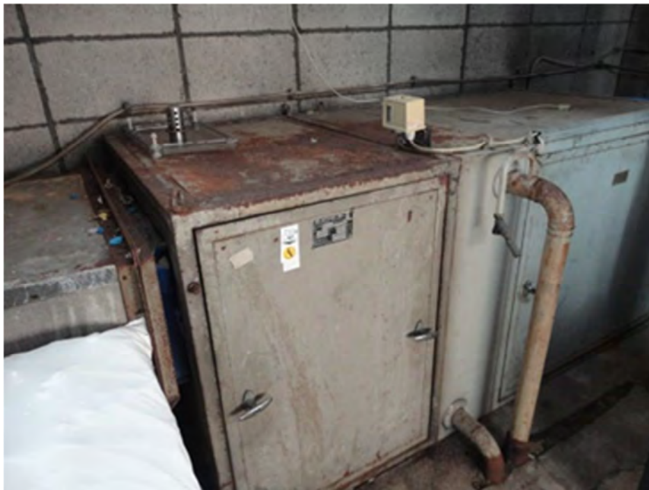
Foto Nr.2 Raumluftechnische Anlage eines Lehrschwimmbads
