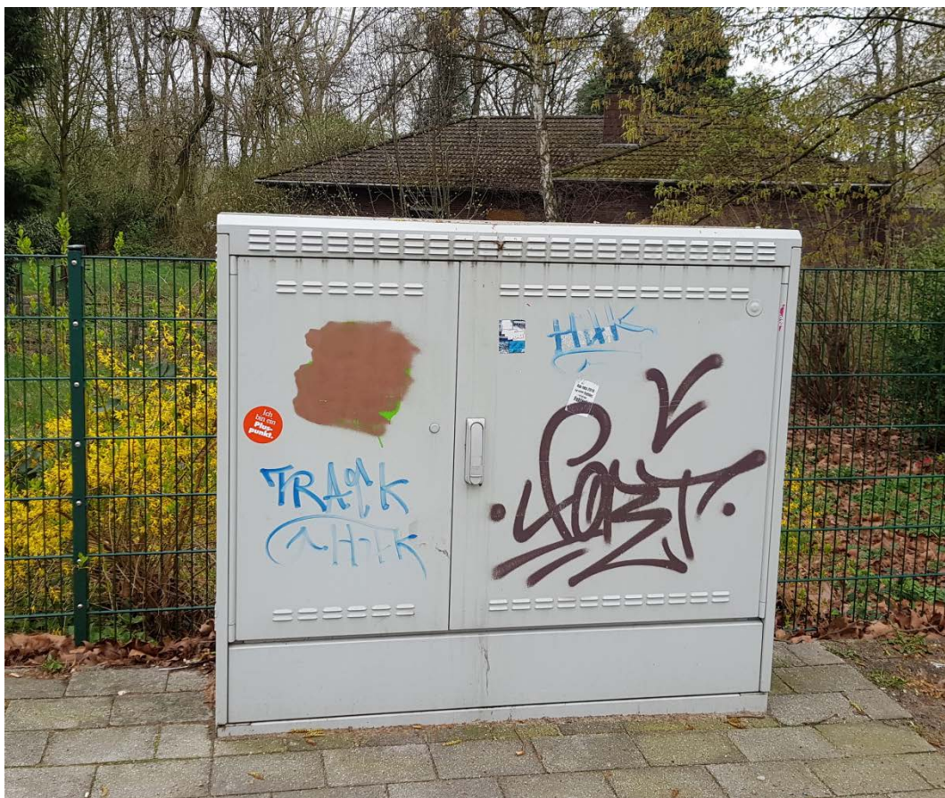
- Telefonverteiler Höhe Teutoburger Straße 210 -
