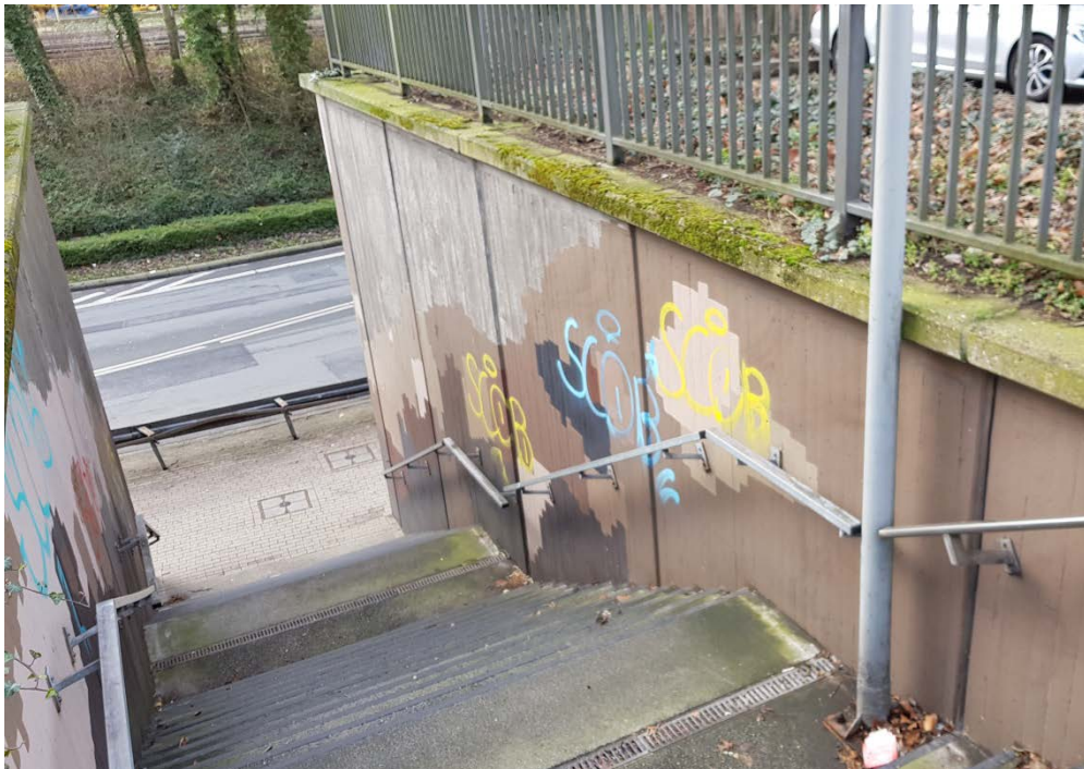
- Wände Fußweg Bottroper Straße Höhe Rathaus Osterfeld -
