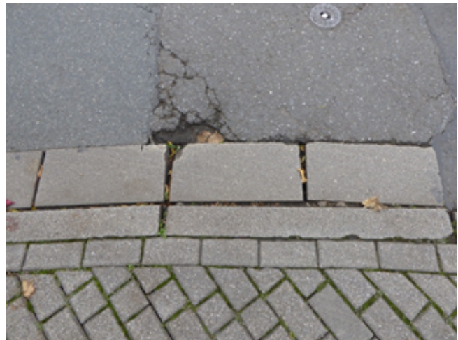
Abbildung 4: Rinnen- und Asphaltschäden
