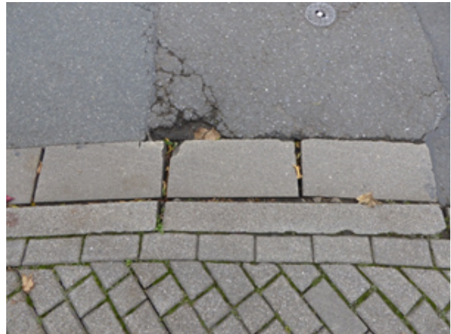
Abbildung 4: Rinnen- und Asphaltschäden
