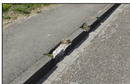
Abb. 1: Ausbrüche von Hochborden
