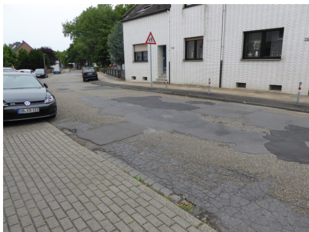
Abbildung 2: Fahrbahnschäden und Gehwegparken
