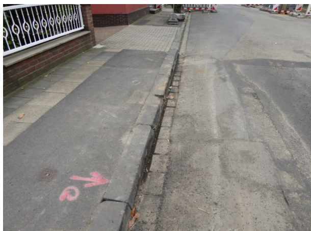
Abbildung 1: Beschädigungen und irreführende Materialien
