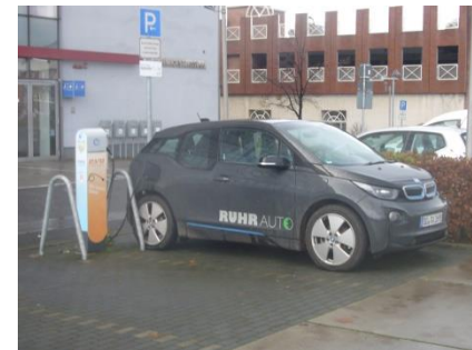
Abb. 7.8-6 E-Mobil-Ladestation am Technischen Rathaus Sterkrade
