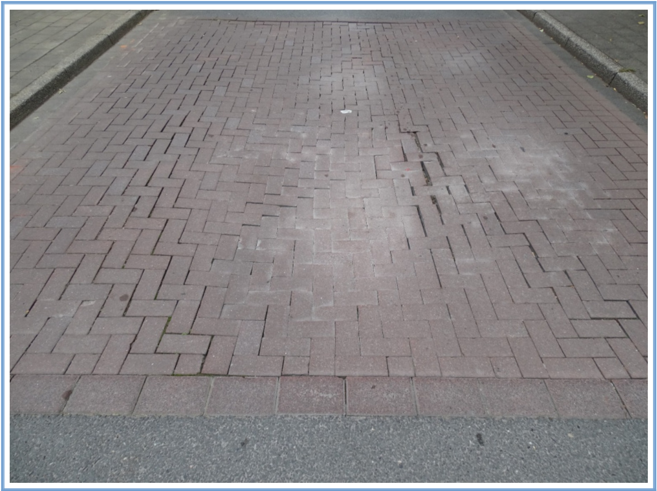
Bild: Die verformte Pflasterfläche im Bereich Lipperstraße 67.
