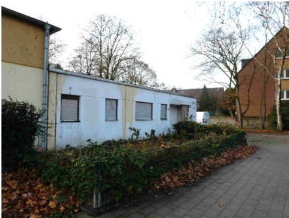
Foto 72: Gebäude nicht mehr in Nutzung
