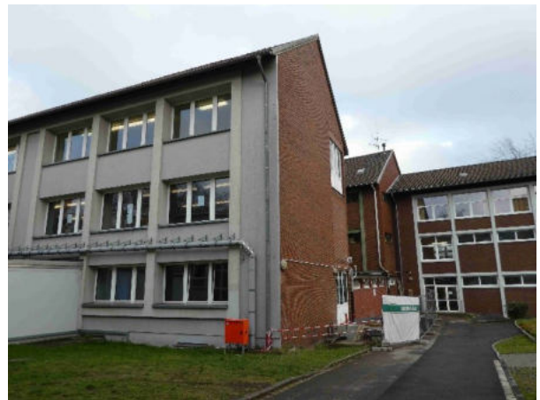
Foto 38: Schulgebäude im Nordwesten mit einer Dachentwässerung, die an der Gebäudefassade von Norden nach Süden abgeführt wird
