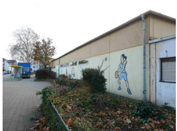
Foto 71: Hallenvorbau mit außenliegender Entwässerung
