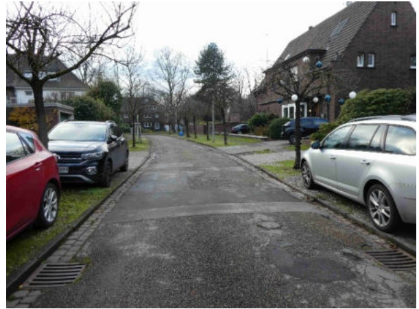
Foto 62: im sanierungsbedürftigen Zustand
