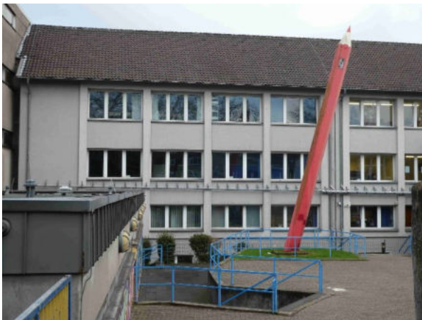
Foto 37: Schulhof in zwei Etagen, im Nordwesten und Gebäude mit Ableitung von Regenwasser entlang der Hausfassade in Richtung Süden
