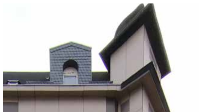
zu geringer Abstand zu Dachkante / Erker
