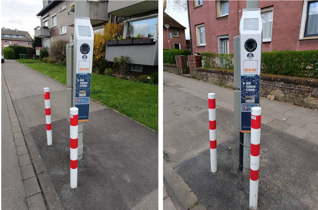
Abb.: Laternenladeinfrastruktur an der Flugstraße 40 (links) und an der Weierstraße 50 (rechts)
