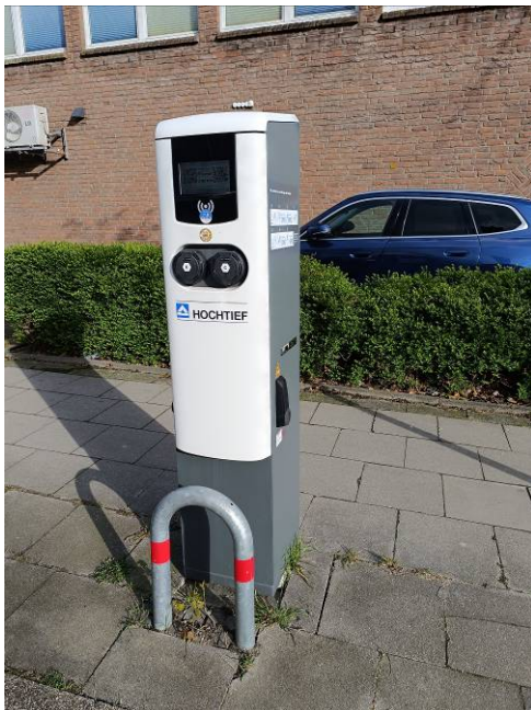
Abb.: Beispiel einer AC-Ladesäule an der Ecke Oranienstraße/Dudelerstraße
