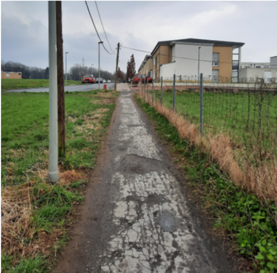
Abb. 1 Baulicher Zustand der Wegeverbindung (Stand März 2024)
