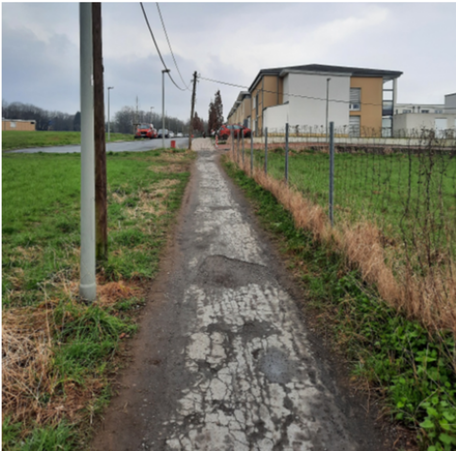
Abb. 1 Baulicher Zustand der Wegeverbindung (Stand März 2024)
