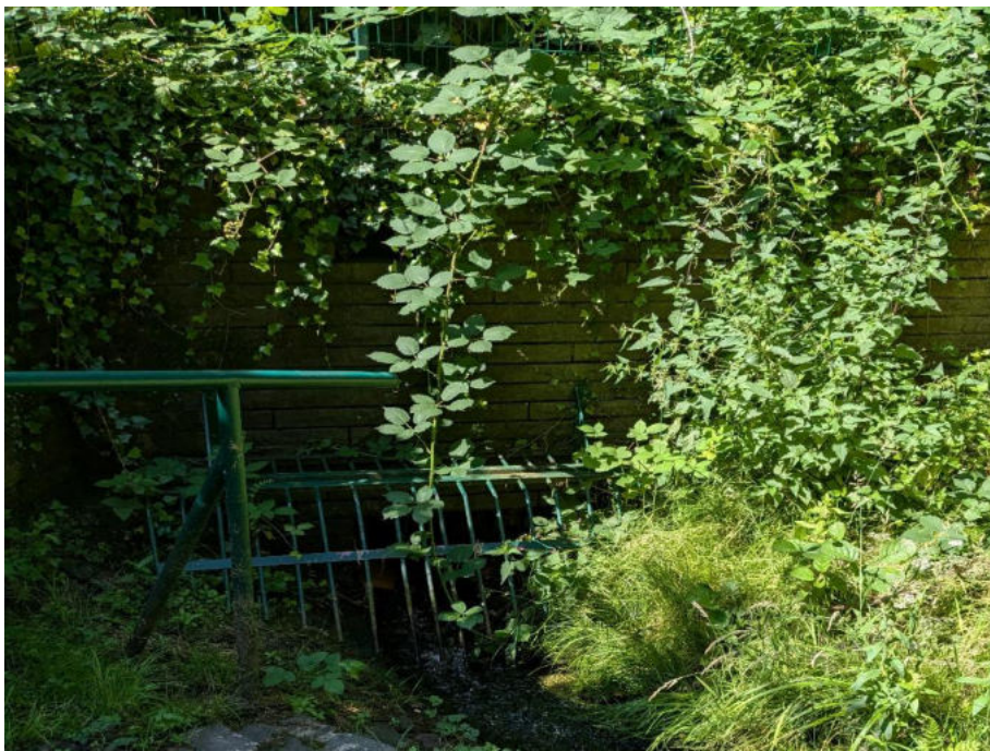
Foto 3: Elpenbach mit Mauer und beginnender Verrohrung
