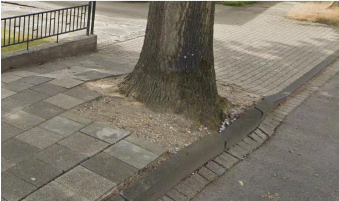
Abbildung 1: Beschädigte Gehwege (Quelle: Google Maps)
